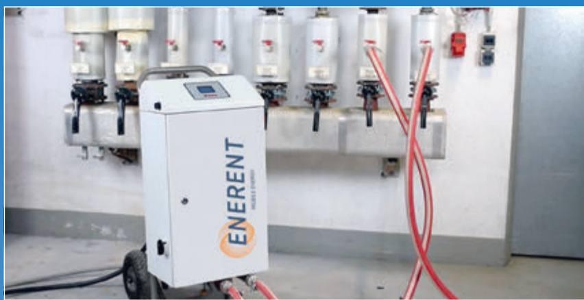
Mobile Heizsysteme lassen sich einfach an bestehende Anlagen anschließen.
